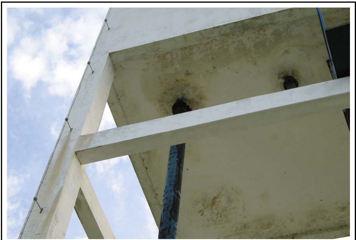
Foto 09 - Sistema de Abastecimento Chaval Barroquinha, ETA de Itaúna: Reservatório Elevado.
