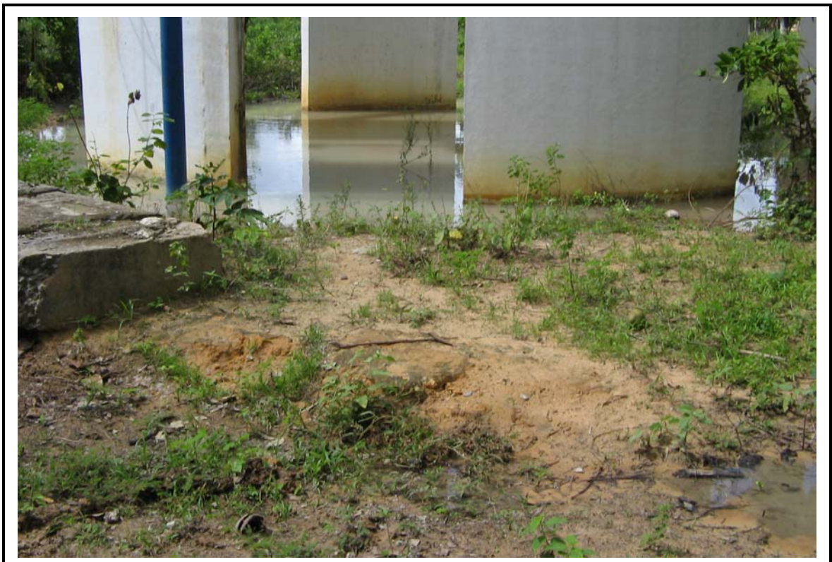
Foto 14 - Sistema de Abastecimento Barroquinha: Base do Reservatório encharcada por vazamentos.
