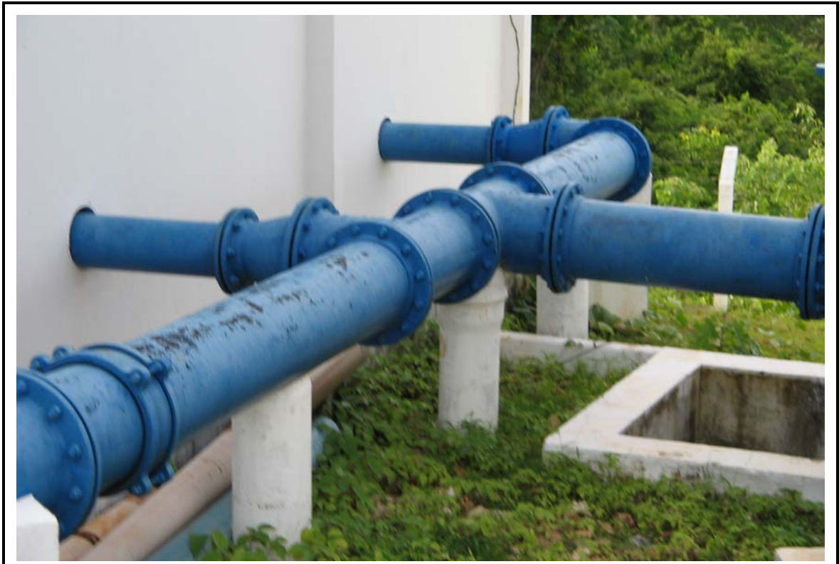
Foto 05 - Sistema de Abastecimento Chaval Barroquinha, ETA de Itaúna: Tubulações entre os filtros e o reservatório de Água Tratada.
