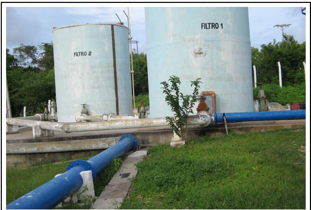
Foto 06 - Sistema de Abastecimento Chaval Barroquinha: Outra Vista dos Filtros.
