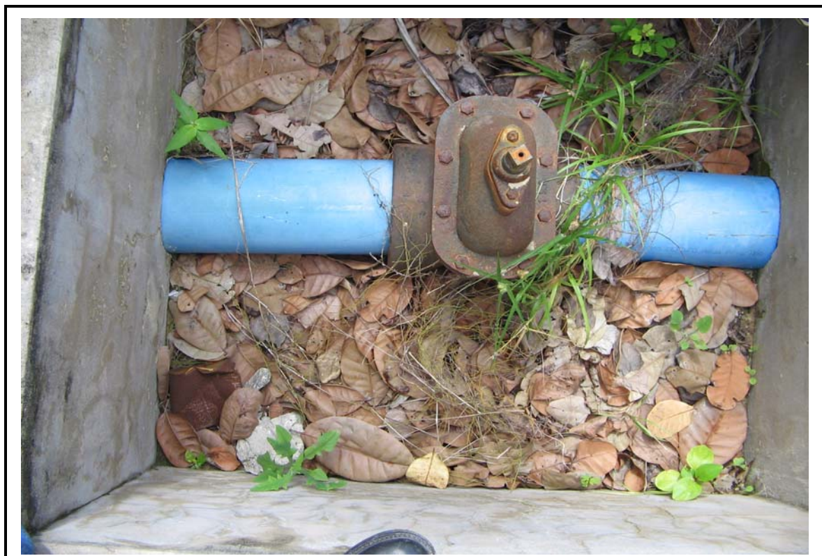
Foto 02 - Sistema de Abastecimento Chaval Barroquinha: Registro de gaveta da linha adutora.
