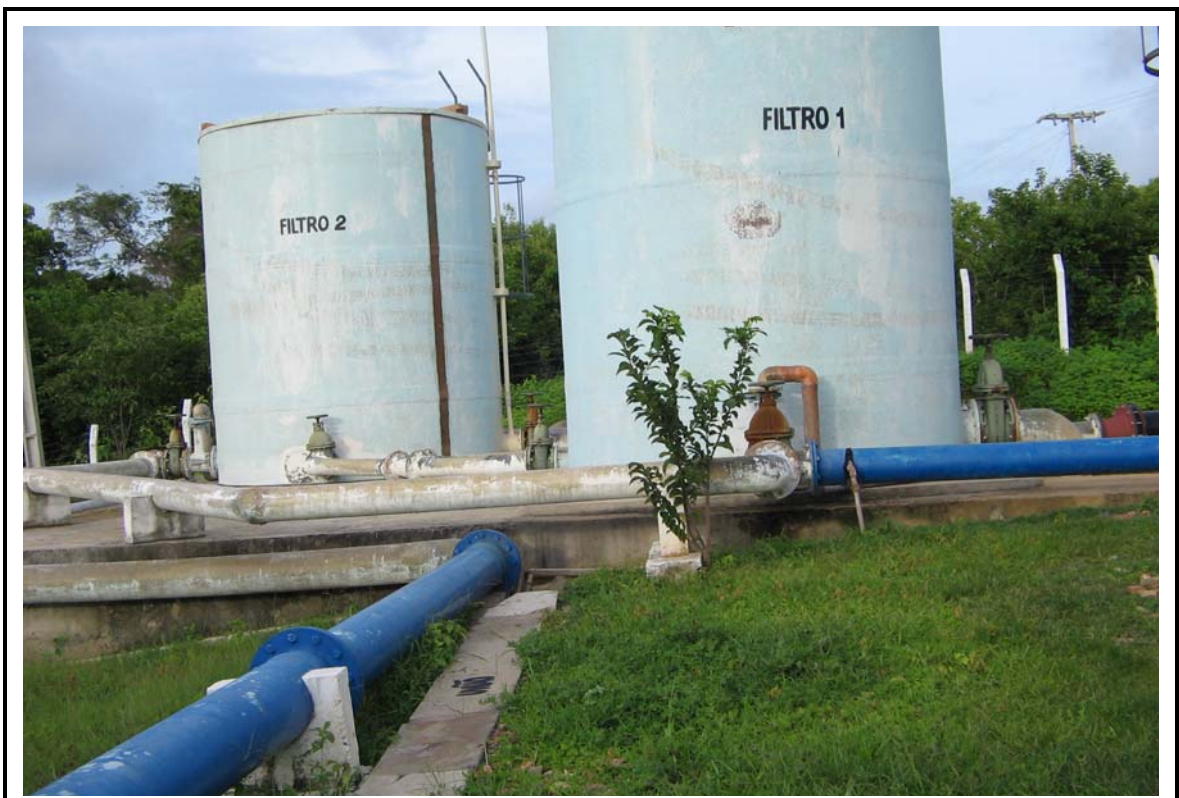
Foto 04 - Sistema de Abastecimento Chaval Barroquinha, ETA de Itaúna: Vista dos Filtros.
