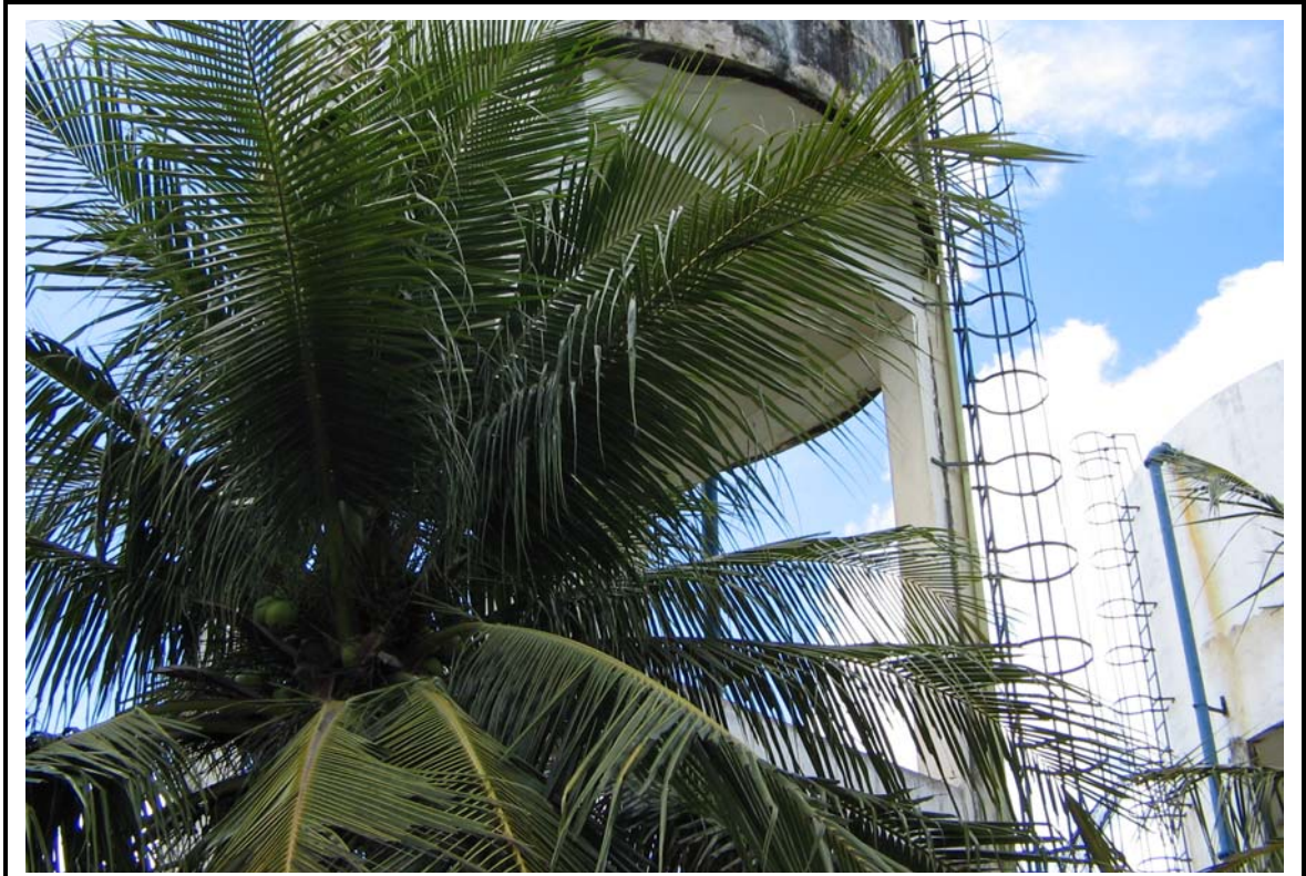
Foto 11 - Sistema de Abastecimento Chaval Barroquinha: Reservatório Elevado de Barroquinha.
