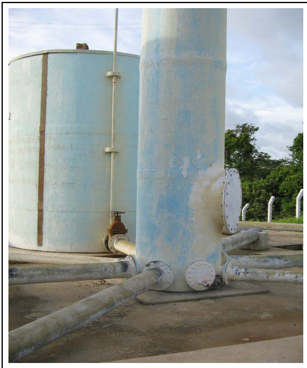
Foto 07 - Sistema de Abastecimento Chaval Barroquinha, ETA de Itaúna: Câmara de Carga dos Filtros.
