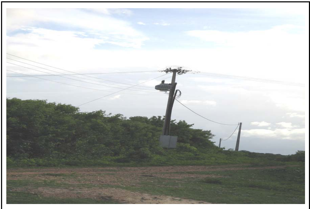
Foto 10 - Sistema de Abastecimento Chaval Barroquinha, ETA de Itaúna: Linha elétrica que abastece a ETA.
