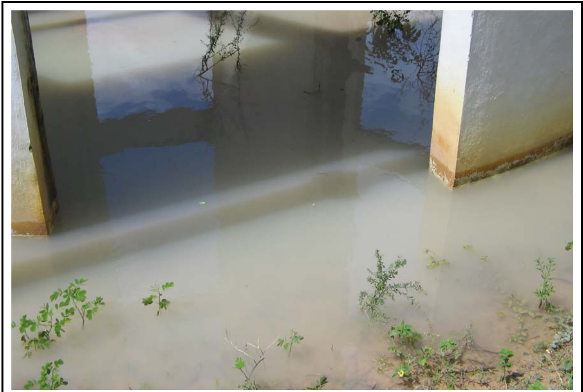
Foto 13 - Sistema de Abastecimento Barroquinha: Base do Reservatório encharcada por vazamentos.
